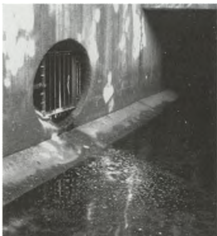
Bild 9: Ausgeschüttetes Putzwasser hat in Niedrigwassersituationen unmittelbare Schädigung. – Der Durchmesser des Zu- laufs lässt die hydraulische Situation beim Starkregenereignis erahnen.
