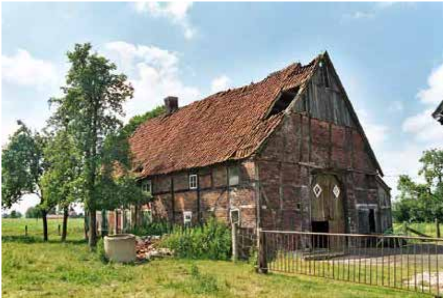
Abb. 6: Viele Bauten werden, wie dieser Kotten im Münsterland, nicht sofort abgerissen, sondern noch einen Zeit lang genutzt. Jede Art von Erhaltungsmaßnahmen unterbleibt jedoch: Restnutzung „auf Verschleiß“.
